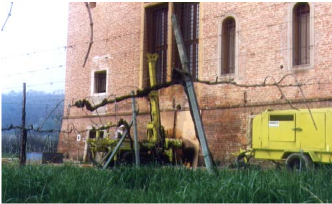
Installazione della sonda per l'esecuzione di un sondaggio con inclinazione di 10° rispetto alla verticale
